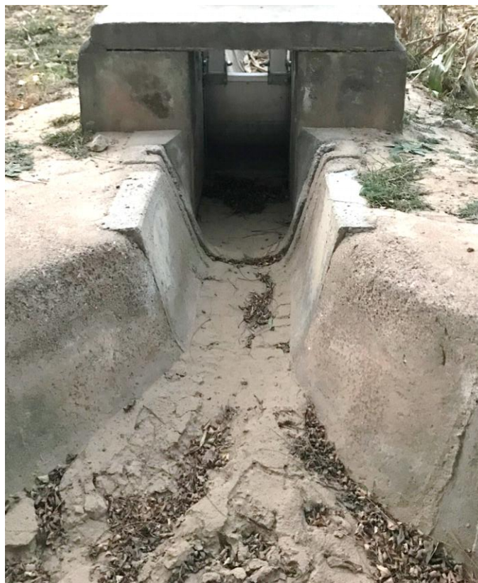
建筑物量水法平直段 几次放水后的淤积情 况
