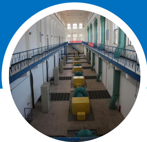
泵站新改造机组
